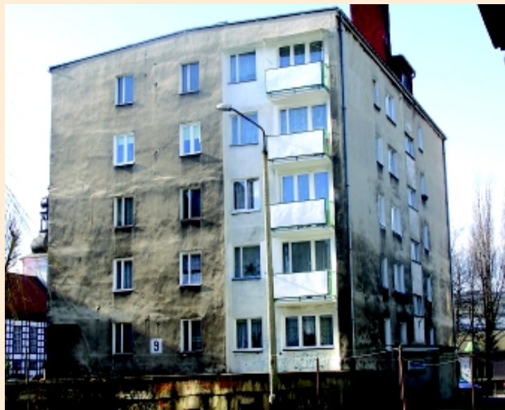
Jeśli powiodą się plany przedsięwzięcia termomodernizacyjnego za około dwa lata elewacje budynków nie będą straszły swoim wyglądem ale także spełniały wymogi termoizolacyjne
